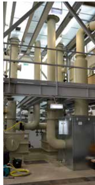
Pilotanlage am Lehrstuhl
