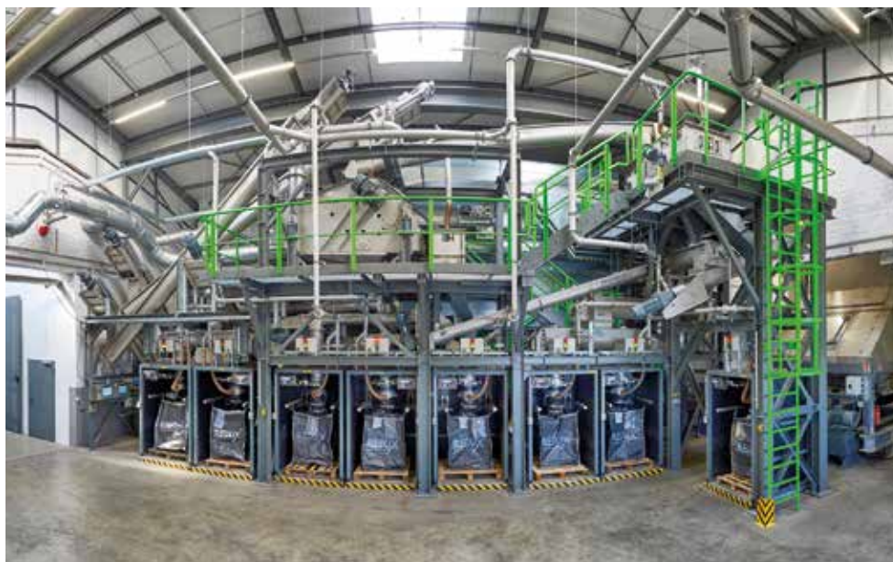
Recyclinganlage in Bremerhaven
