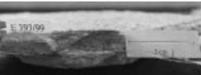
Abb. 1: Typisches Schadensbild einer von der Fassade abgelösten Putzschicht (Bild: Institut für Gesteinshüttenkunde)
